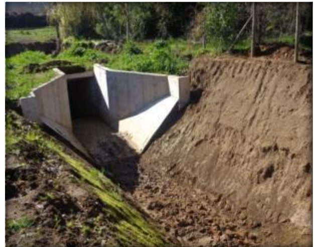
Cámara de salida de Sifón Fortaleza.
